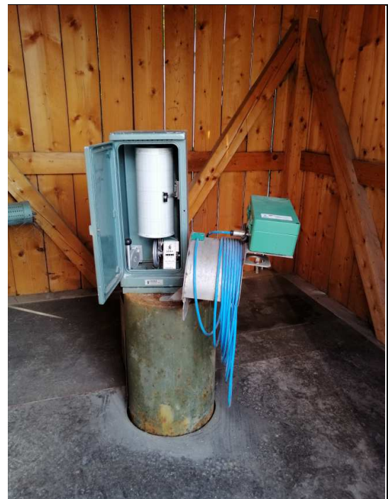
Abbildung 3: Bohrung REI 6 mit Brunnenstube und Situation an der GOK
