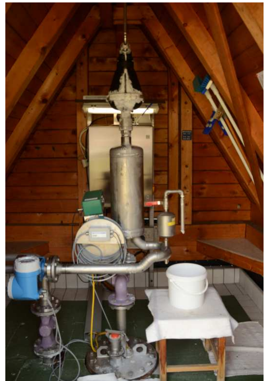
Abbildung 5: Bohrung REI 8 mit Brunnenstube und Situation an der GOK
