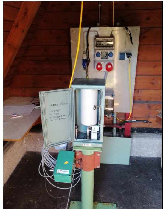
Abbildung 4: Bohrung REI 7 mit Brunnenstube und Situation an der GOK
